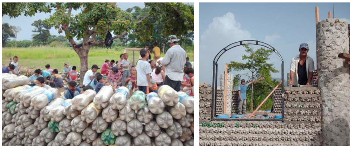
図 3-10 ホンジュラスでのペットボトルを使った学校建設の写真
